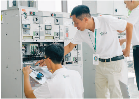
Cấu hình lắp đặt RTU Configuration and installation of RTUs
